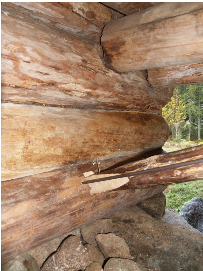
2020-10-08: Slutbesiktning Nedtill går järnstaget genom stocken via ett borrarat hål. På utsidan har järnet en u-form med spets som slagits in i stocken.
