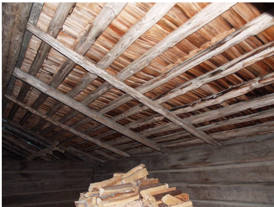
2019-11-22: På insidan syntes fuktgenomslag och svarta märken där rötan hade gått igenom spånen.
