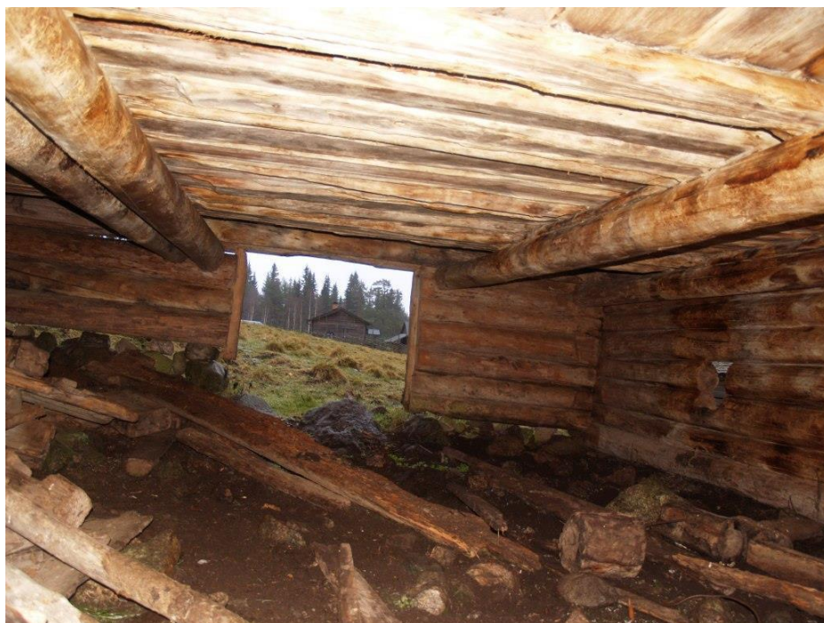
2019-11-22: Det är en svag konstruktion eftersom sammanbindande syll saknas och korna går in under byggnaden vilket tryckt ihop marken mot grundstenarna.
