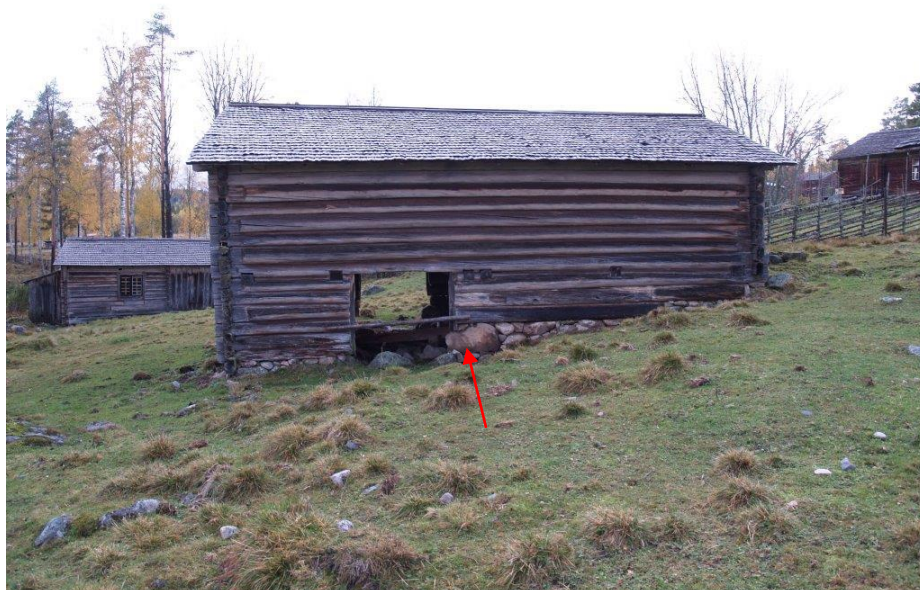
2020-10-08: Slutbesiktning Långsida B efter åtgärd. En större sten togs fram och lades in vid dörröppningen för att bromsa fortsatta rörelser. Marknivån sänktes genom grävning längs långsidan och stenvallen staplades om.
