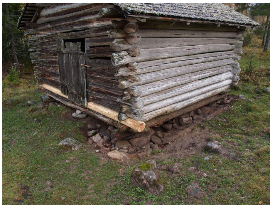
2020-10-08: Slutbesiktning En bredare stenkista har byggts upp under hörn DA för att möjliggöra fortsatta lyft och uppbyggnad av hörnstöden.
