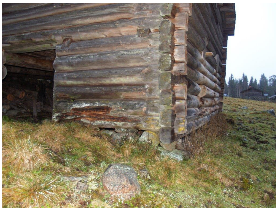
2019-11-22: Rundtimmerstockarna D1 och D2 hade rötskador och byttes ut när arbeten med grund och stomme ändå skulle göras.
