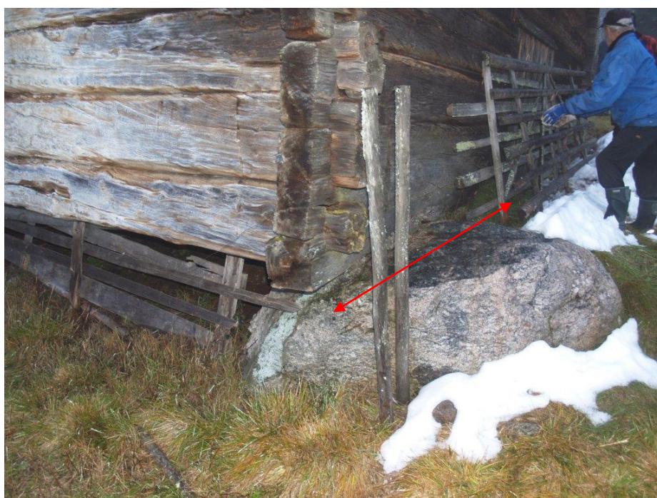
2019-11-22: Syllen skulle bytas från hörn BC fram till dörröppningen. Stommen vilar på en bra hörnsten.
