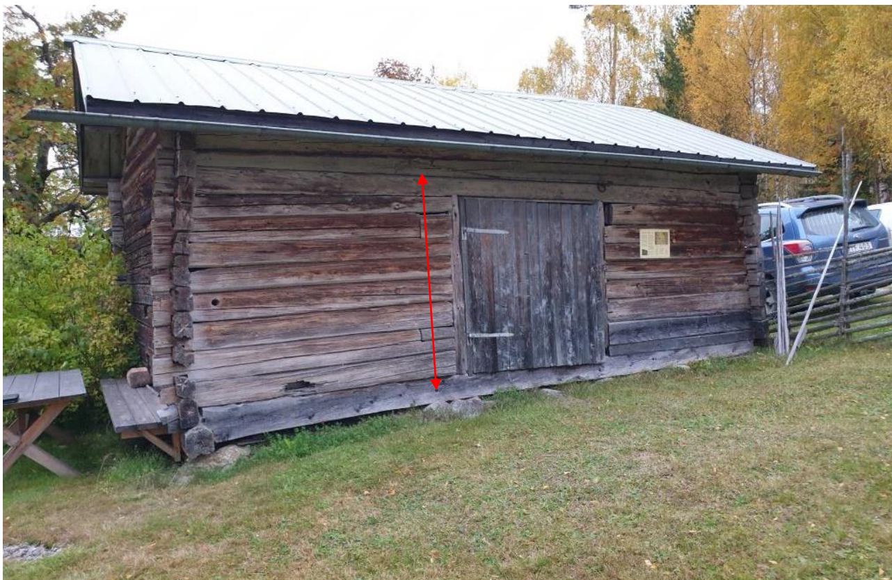
2021-09-28: Vedboden hade halkat iväg i hörn AB. Följare skulle placeras på insidan av långsidedörrarna för stabilisering av väggen.
