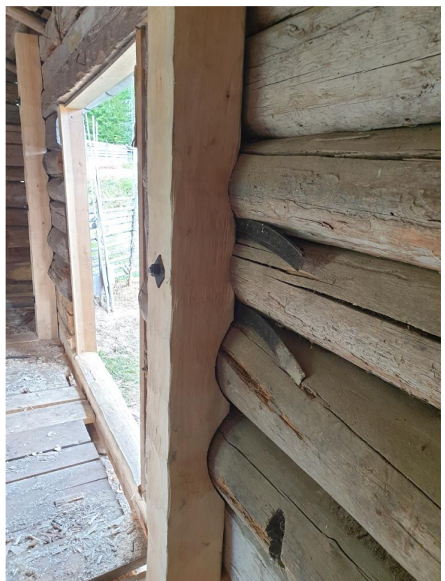
2022-09-09: Slutbesiktning Följarnas insida formades efter väggens ojämnheter istället för att väggen skulle huggas slät efter följarnas form.
