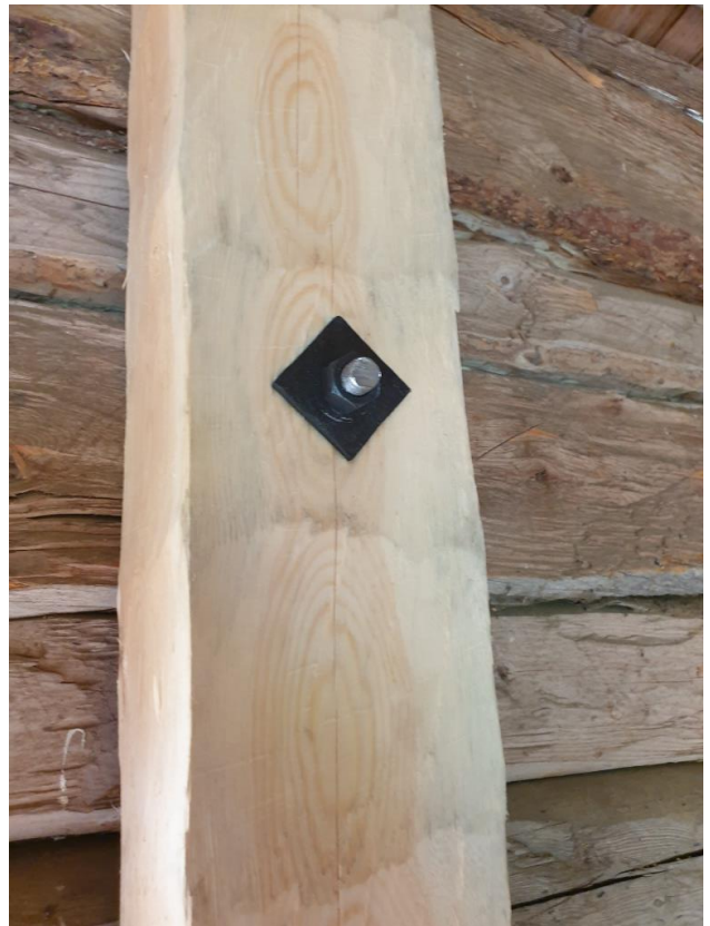
2022-09-09: Slutbesiktning Mutter och gängstång på insidan.
