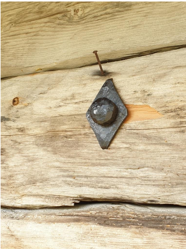
2022-09-09: Slutbesiktning Smidd bricka på utsidan med nabbar som hindrar den att rotera.
