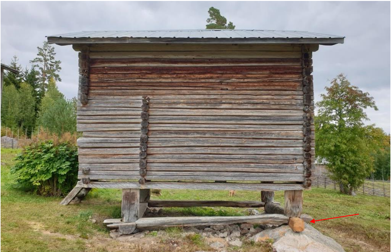
2022-09-09: Slutbesiktning Härbrets syllram C, baksidesgaveln, har bytts ut och grunden justerats så att mushyllan ligger i våg på långsidan D.
