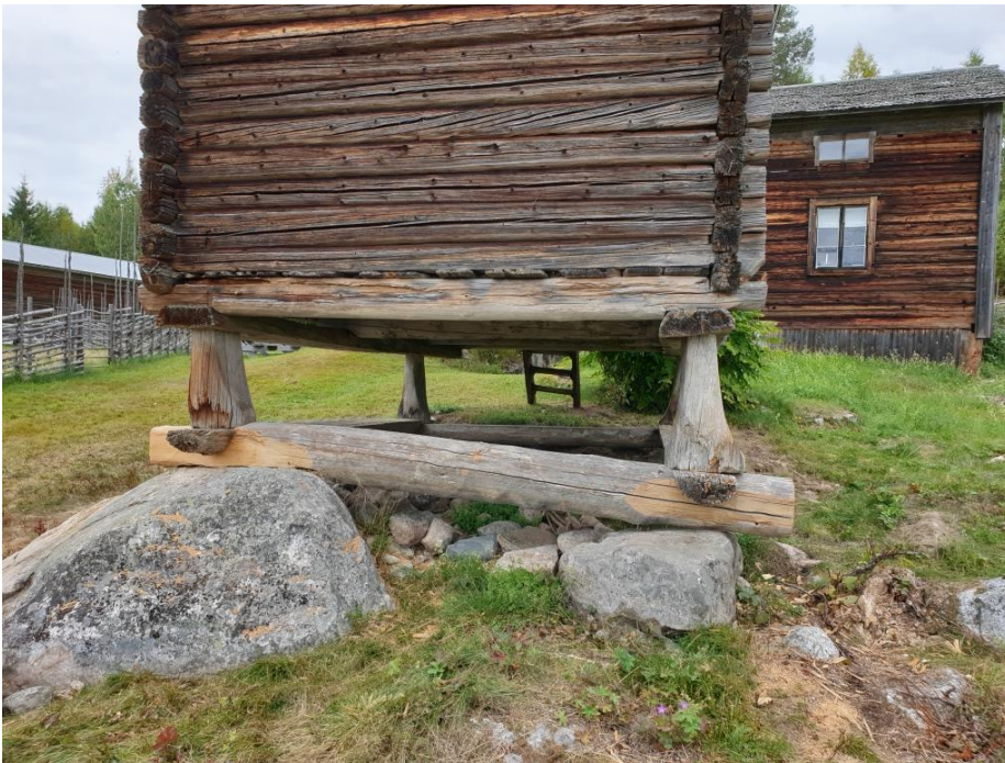
2022-09-09: Slutbesiktning Underredet är inte rakt eftersom stolparna är olika långa. Byggnaden står i våg medan underredet och grundstenarna har fått anpassas efter stolparnas längd.
