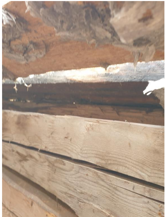
2022-09-10: Fals i väggbandet visar att det innan spåntaket var ett nävertak.
