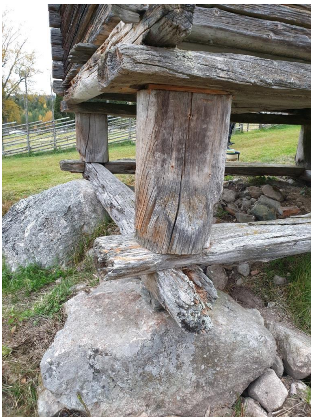
2021-09-28: I knuten, just där syllramen tar upp tryck, var stocken förstörd av röta.
