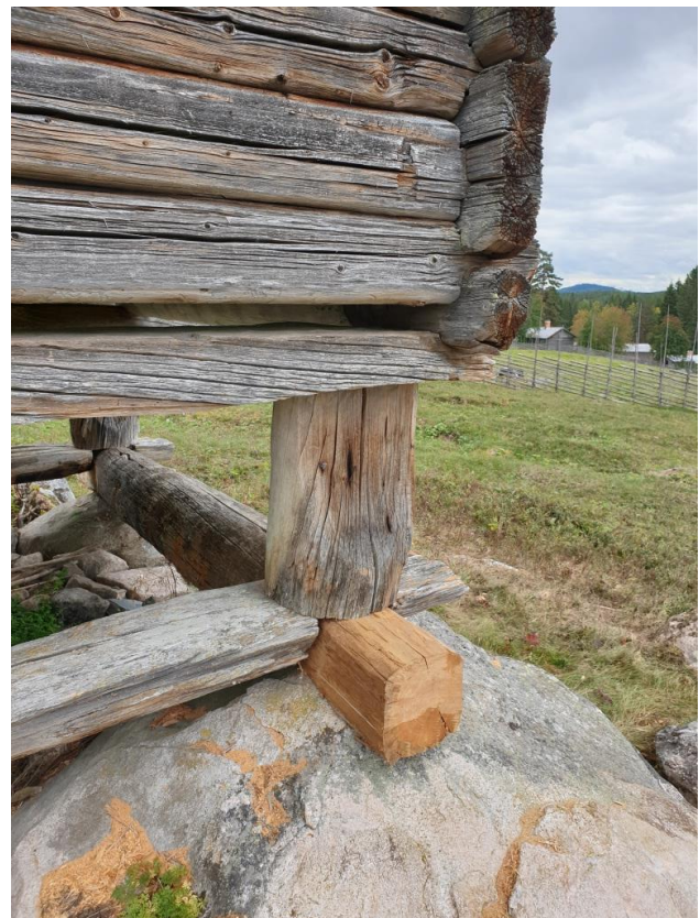
2022-09-09: Slutbesiktning Stocken var en tårraka, en fura död på rot. Det var mindre rötskador i splinten som fick tålas bort.
