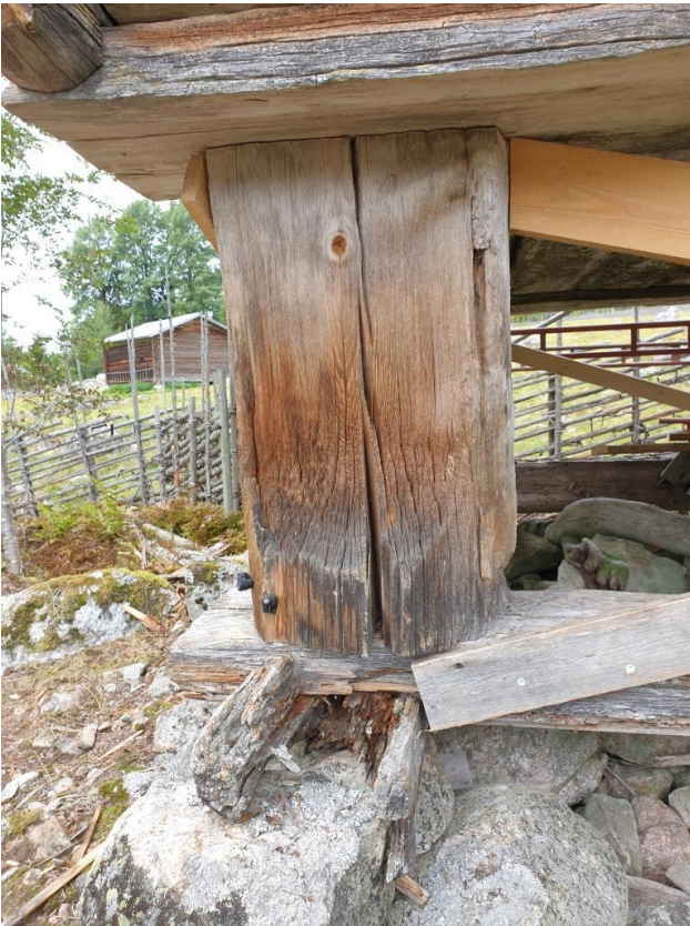
2022-09-09: Det var rötskador i den bakre syllramens ena hörn.
